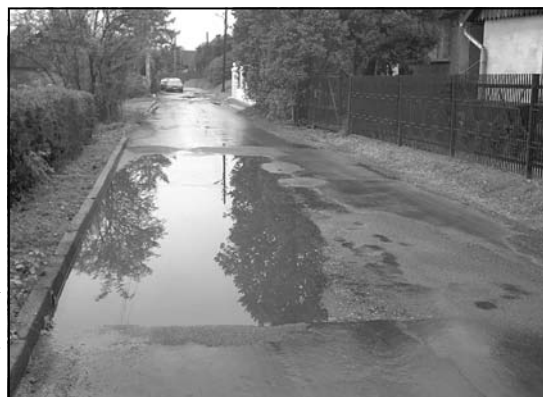
Ulica Ślósarczyka – tu kałuże w kilku miejscach zajmują sporą część jezdni
